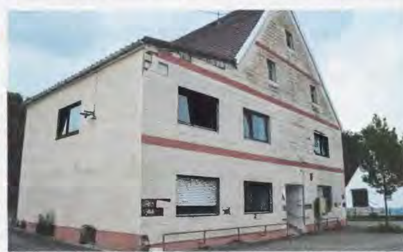
Mittlerweile ist das Gebäude komplett verwaist und in einem katastrophalen Zustand. Es droht der Abriss.
