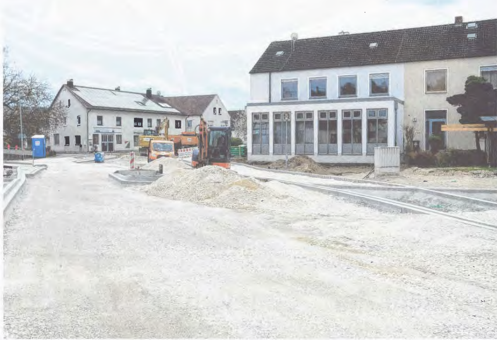
So sieht der aktuelle Stand der Baumaßnahmen an der Ortsdurchfahrt in Haunsheim aus. Rund 527.000 Euro investiert die Gemeinde heuer für die Gehwege. Rechts im Bild ist außerdem das Feuerwehrhaus zu sehen, das modernisiert und umgebaut werden soll. Foto: Tanja Ferrari
